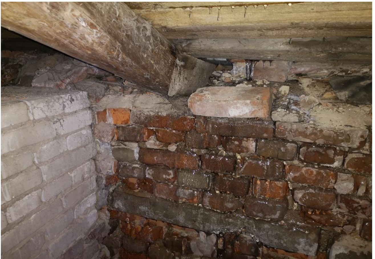
Фото 10. Разрушение мауэрлата, стропильной ноги.
