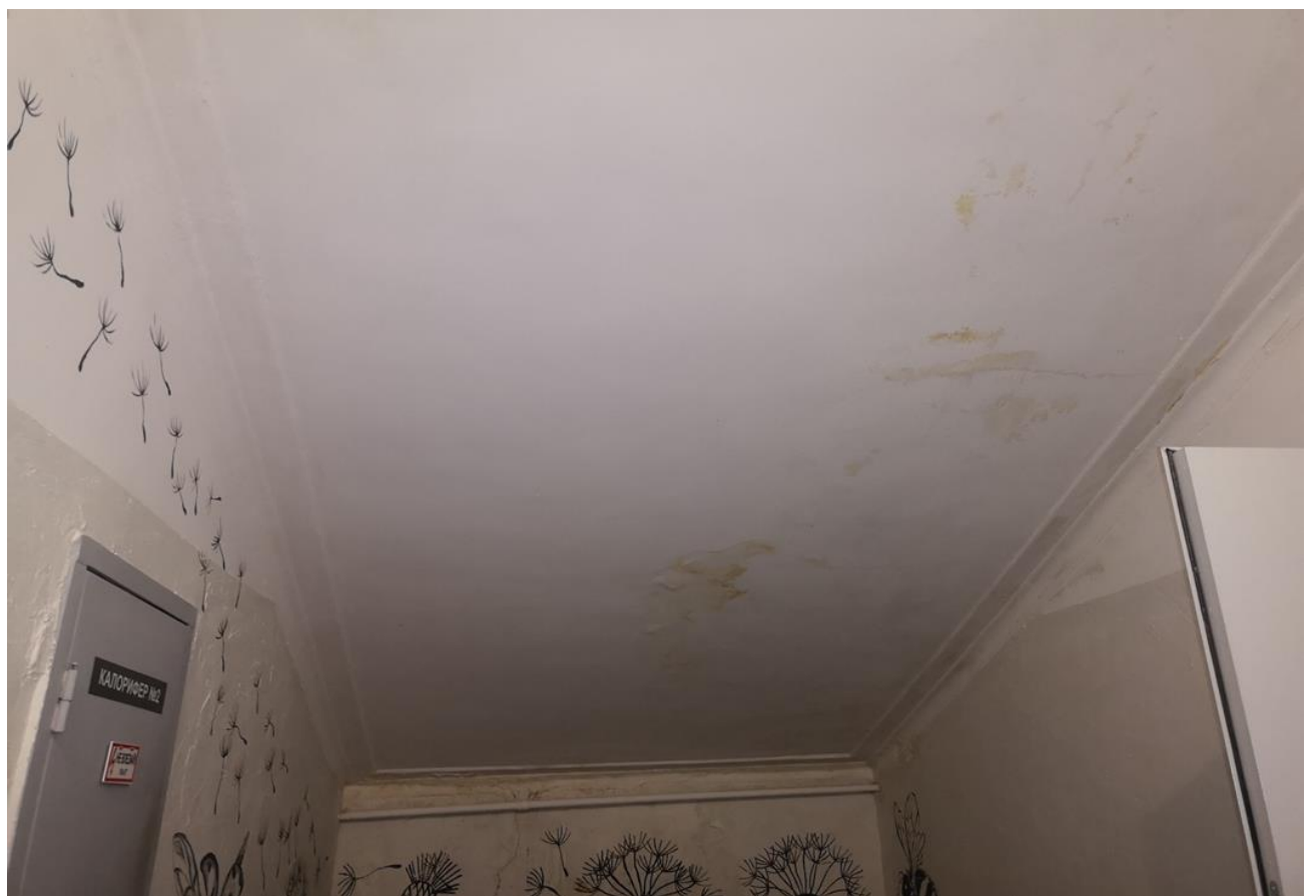
Фото 12. Следы протечек кровли.
