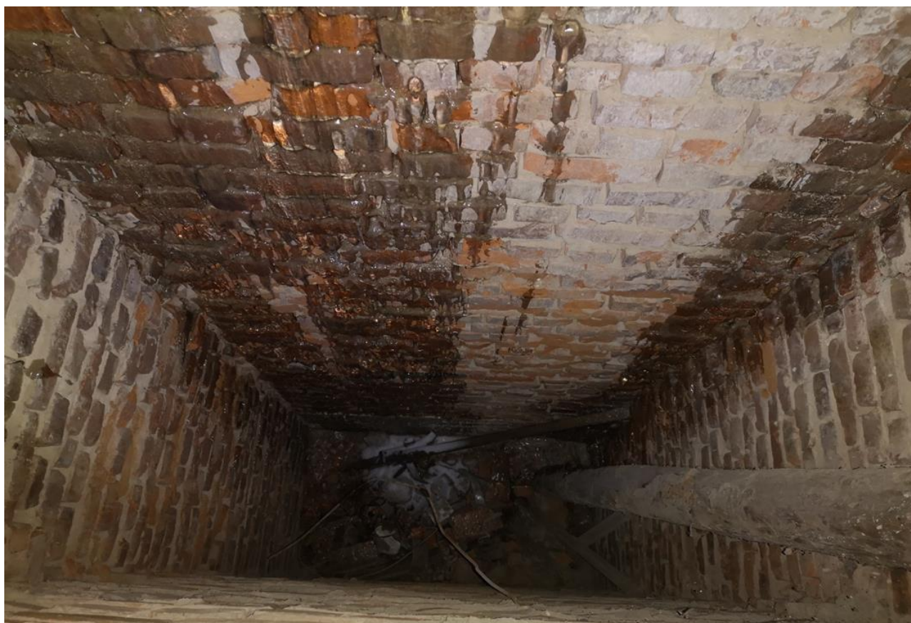
Фото 8. Замачивание стен, трещины в кирпичной кладке.
