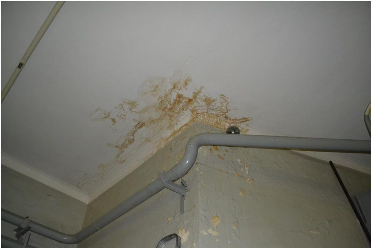
Фото 11. Следы протечек кровли.
